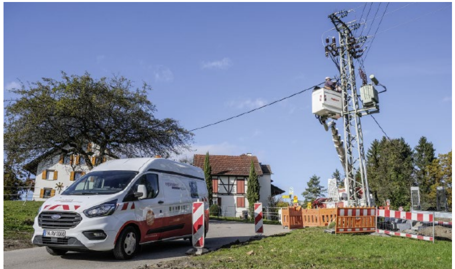
Das Regionalwerk Bodensee sorgt auch im ländlichen Raum für eine sichere Stromversorgung.
