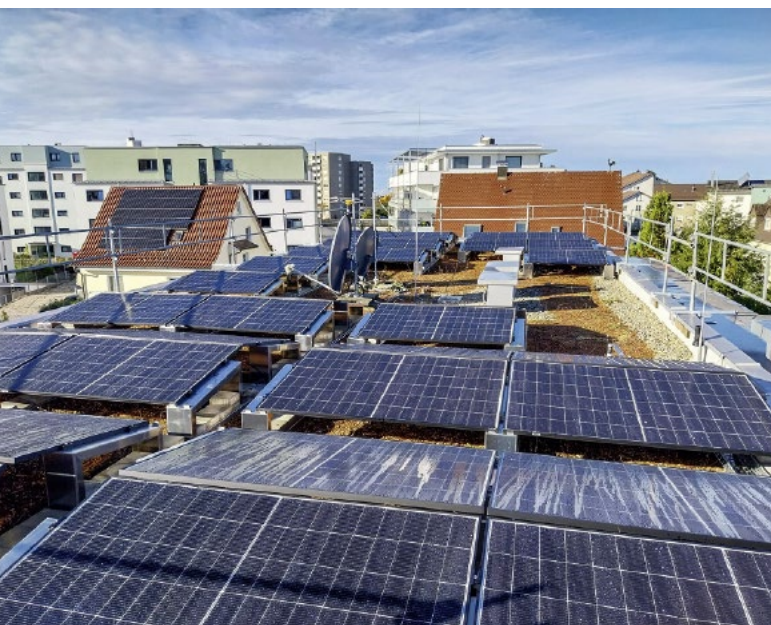
Die neue PV-Anlage auf dem städtischen Gebäude Jahnstraße 13.
