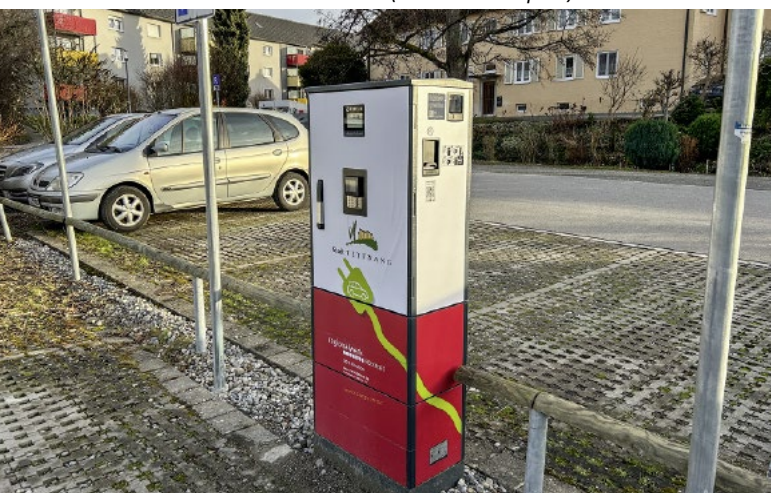
Eine von drei neuen Ladesäulen (hier am Loretopark).
